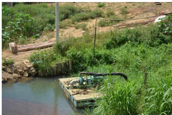
Figura 15: Captação flutuante Rio Paraopeba. Fonte: Conen
