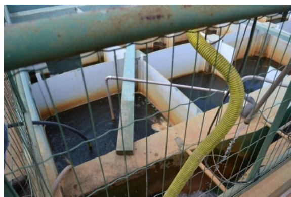
Figura 17: ETA calha Parshall Fonte: Conen
