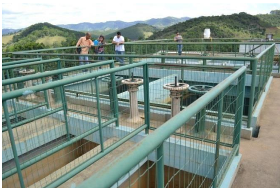
Figura 18: ETA – filtros Fonte: Conen
