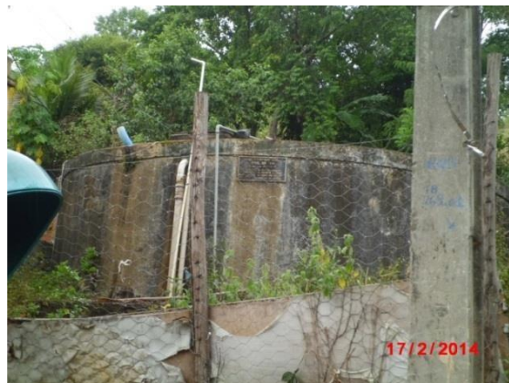
Figura 23: Reservatório Boa Vista/Várzea Fonte: Conen
