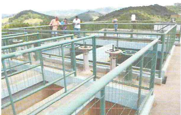
Figura 18: ETA – filtros Fonte: Conen
