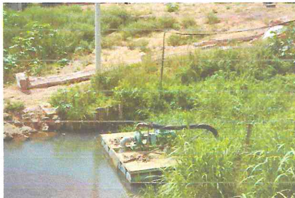
Figura 15: Captação flutuante Rio Paraopeba. Fonte: Conen
