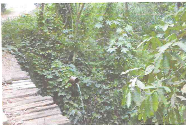
Figura 27: Lançamento de esgoto no córrego. Fonte: Conen
