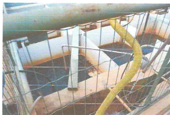
Figura 17: ETA calha Parshall Fonte: Conen
